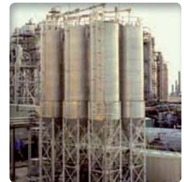
Ligne dédiée haut débit
