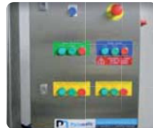
4 L'armoire de commande pour la gestion des dosages et des débits
