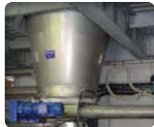
3 Trémie d'alimentation pour le stockage de la matière première
