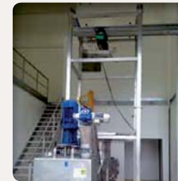
Connexion sur cuve liquide
