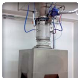
▶ Poste de conditionnement
